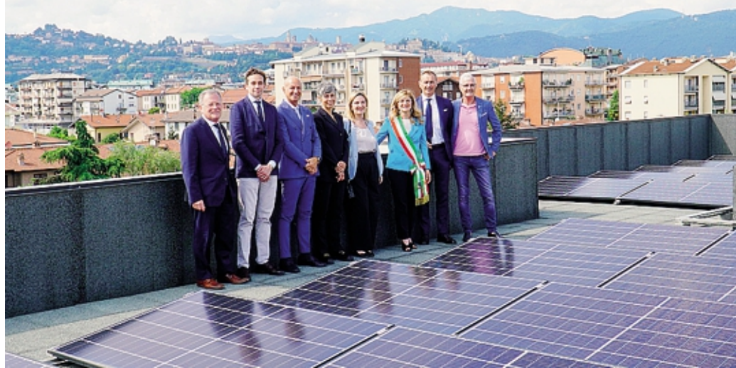
L'impianto fotovoltaico su un edificio all'interno dell'area artigianale di via delle Canovine FOTO COLLEONI
